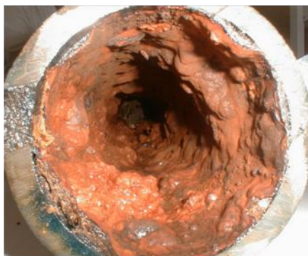
Figure 3 : une canalisation recouverte par un biofilm (5)
