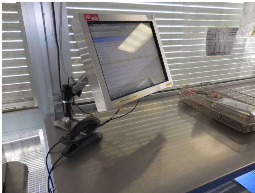
Figure 19 : Installation d'un panel PC en zone de lavage
